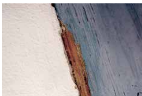
Vorstehende Putzkante: die ungünstige Wasserführung erleichtert das Eindringen von Feuchtigkeit
