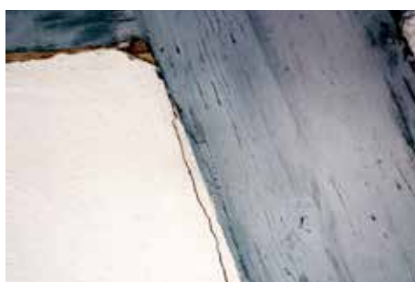
Putz wurde nicht mit einem feinen Messerschnitt vom Holz getrennt
